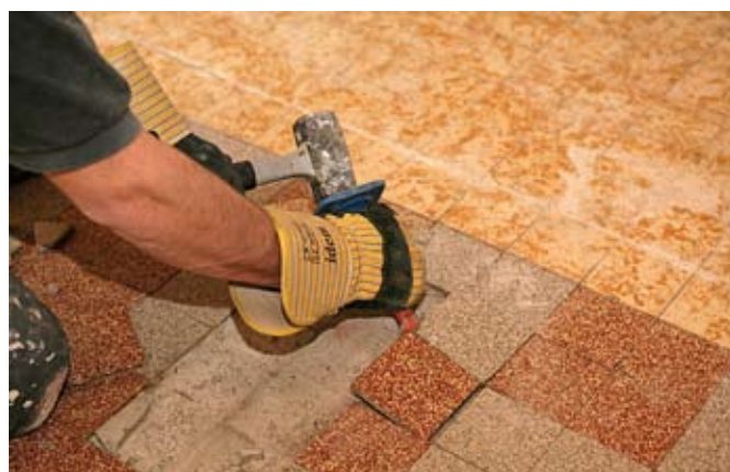
Les parties non adhérentes du revêtement ont été sondées. Les carreaux désolidarisés du support sont éliminés.
