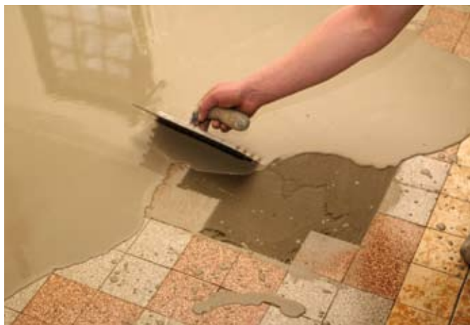
Les parties lacunaires sont comblées et un primaire est appliqué sur la surface à carrelé.
