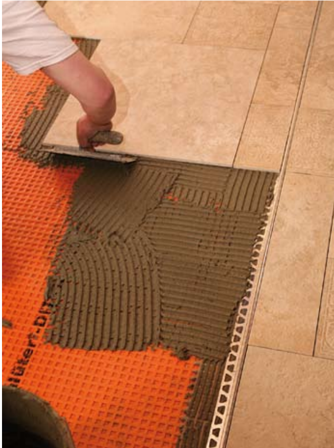
Le joint de fractionnement a été implanté ; ses ailettes de fixation sont noyées dans le mortier-colle. Les alvéoles de la natte sont emplies de colle et le calepinage est mis en œuvre.
