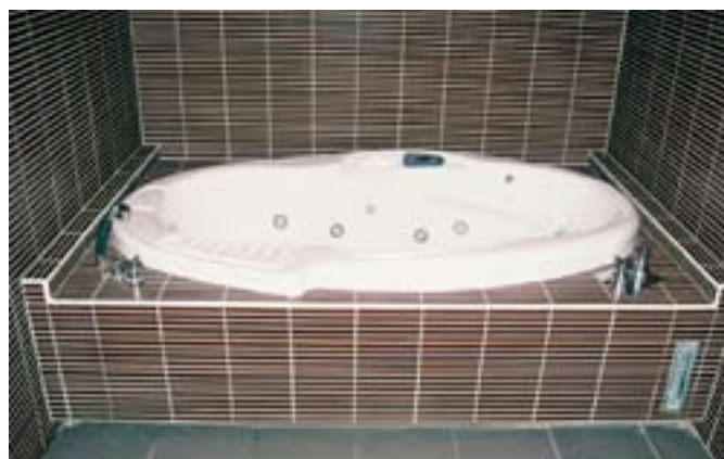
Des aménagements permettent aux personnes à mobilité réduite d'accéder à la baignoire balnéo.
