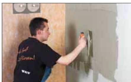
1 Appliquer du mortier colle (spatule crantée de 3 x 3 mm) pour le collage de l'étanchéité composite Schlüter®-KERDI.
