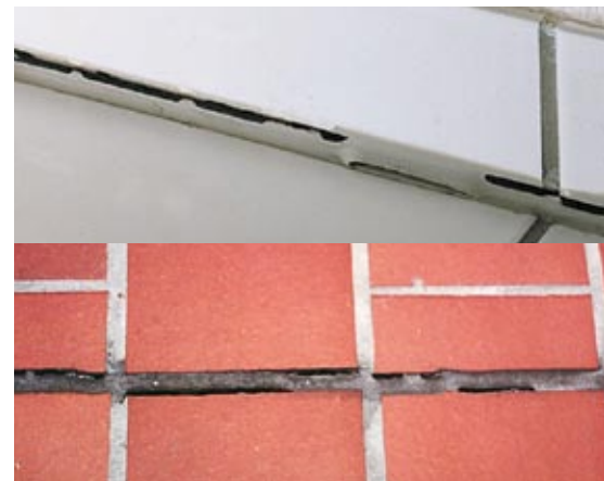
Les joints de mouvements Schlüter®-DILEX permettent d'éviter l'apparition de ce type de dommage.
